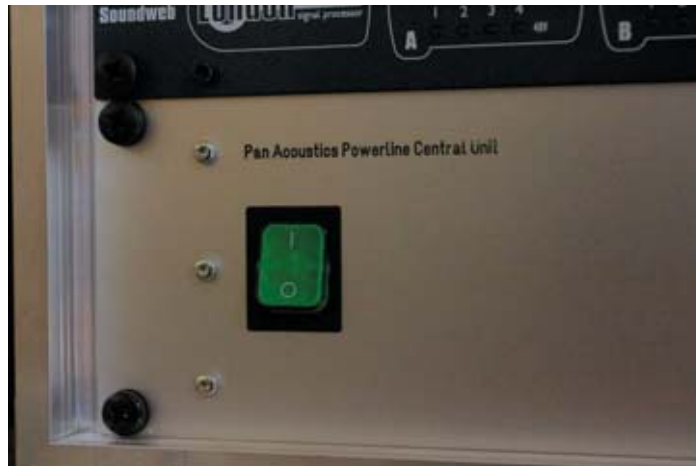
... und Detailansicht der PowerLine-Zentraleinheit
